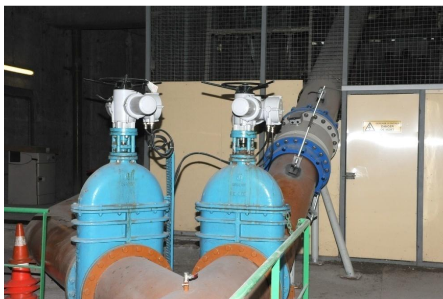
Canalisation de refoulement du poste de pompage principal rive gauche
