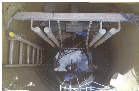
Exemple : poste de refoulement du nouveau cimetière
