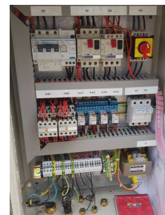
Exemple : Armoire électrique du poste Winchester
